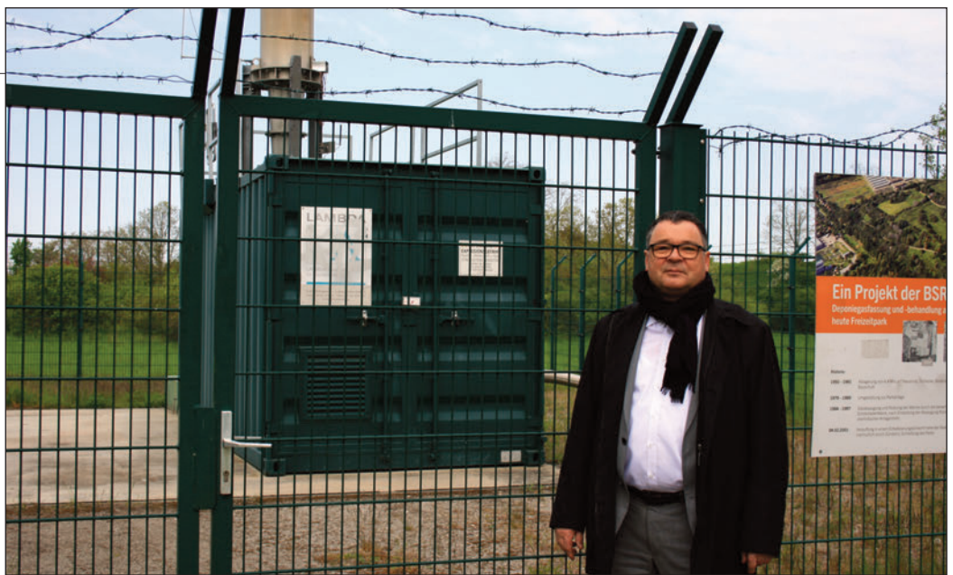
Der Ingenieur und Energieexperte Rolf Naster vor dem Container im Freizeitpark, in dem das Gas der ehemaligen Mülldeponie nutzlos abgepackt wird.
